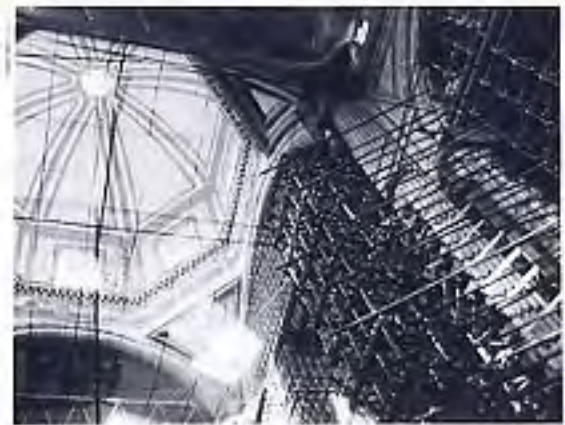
Interior Catedral de Ciudad de México en estado de hundimiento
